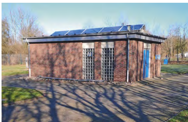
Photovoltaikanlage auf dem Dach des Pumpwerks Willi-Melchers-Straße
